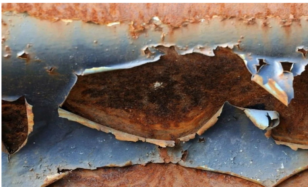
Рисунок 3 – Пример значительных коррозионных повреждений поверхностного слоя
